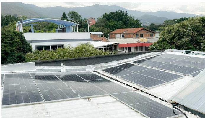
Paneles Solares - Sede Santiago de Cali
